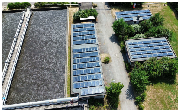
Impianto di Cassano D'Adda - Cascina Roncella
